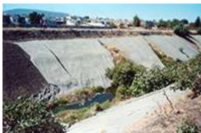
Daño en bordos del Río Guanajuato ocasionado por dos fallas geológicas activas Fraccionamiento San Roque
