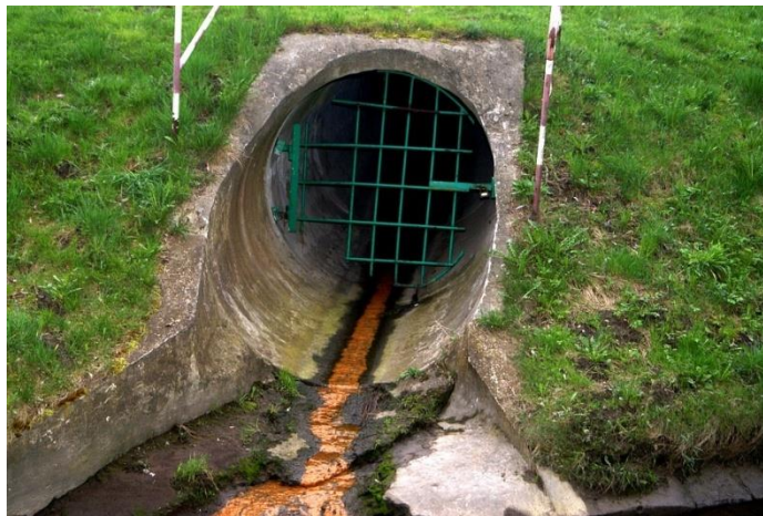
Fig. 40. Derrame de sustancias químicas peligrosas a través del alcantarillado. 2
